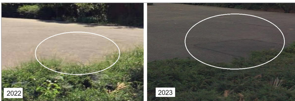
Afbeelding B1-1: Reparatievakken speelveld 2022 -2023 (bron: Cyclomedia StreetSmart)
